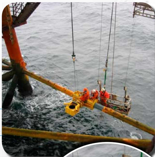
Plates-formes ALTA pneumatiques, plate-forme pétrolière, mer du Nord
